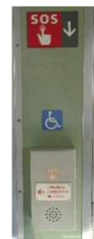
非常通報装置 2
