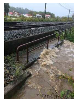
黒姫駅～妙高高原駅間 水位が上昇した古海橋梁
