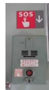
非常通報装置 1
