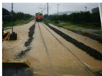
三才駅～豊野駅間 冠水した線路
